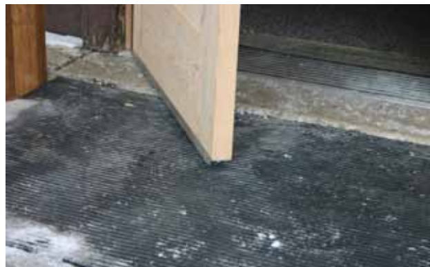
Ancienne Gare du Canadien Pacifique, Portage-la-Prairie (Manitoba). L'ajout de coupe-bise à une porte récemment refinie offre une protection contre les intempéries.
