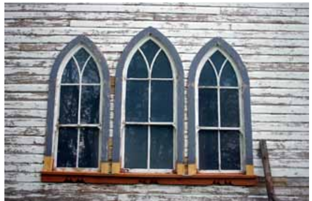
Église anglicane St. Paul, région de St-Francois-Xavier (Manitoba). Les encadrements de fenêtre sont conservés et réparés en intégrant des matériaux nouveaux assortis aux anciens.
